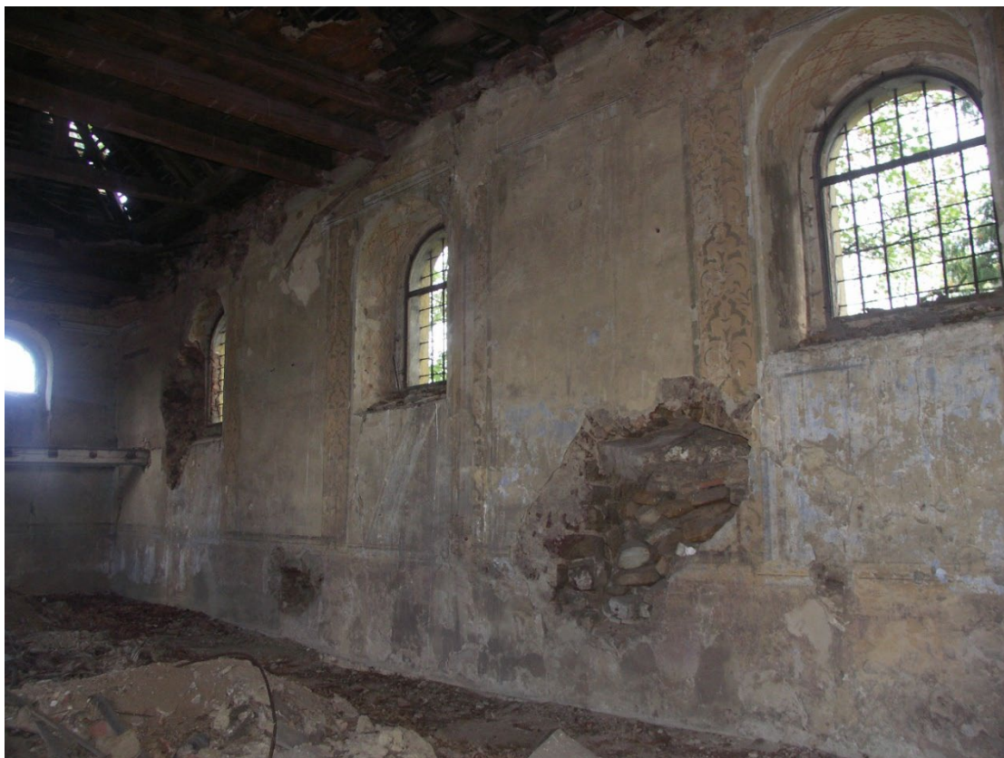
Severní stěna lodi v pohledu od jihovýchodu. Vpravo patrná zarděná nika středověkého vstupu. Foto: Lucie Radová 2007.
