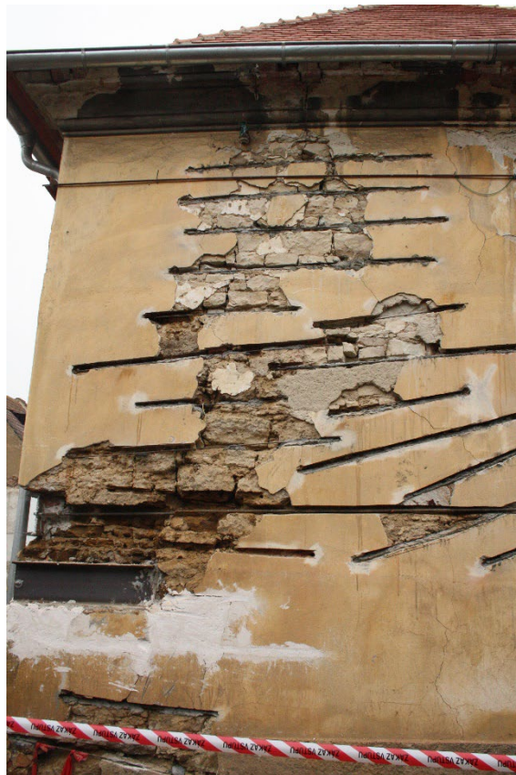
Detail jihovýchodního průčelí presbytáře s patrnou oblastí zdiva z opukových lomových kamenů se starší vrstvou pekované omítky nad spodní partií užívající tmavě hnědý kámen pískovcový. Foto: Jaroslav Skopec 2013.
