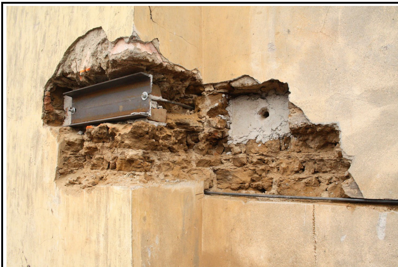
Detail odhaleného zdiva v jižním koutě svíraném lodí a presbytářem. Foto: Jaroslav Skopec 2014.
