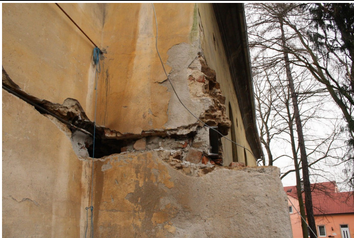
Detail opěrného pilíře severovýchodního nároží lodi, jehož vrchní partie byla při statickém zabezpečení odbourána. Ze situace je zřejmé, že zdivo opěráku je shodné s obvodovým zdivem lodi, se kterým je provázané. Foto: Jaroslav Skopec 2013.
