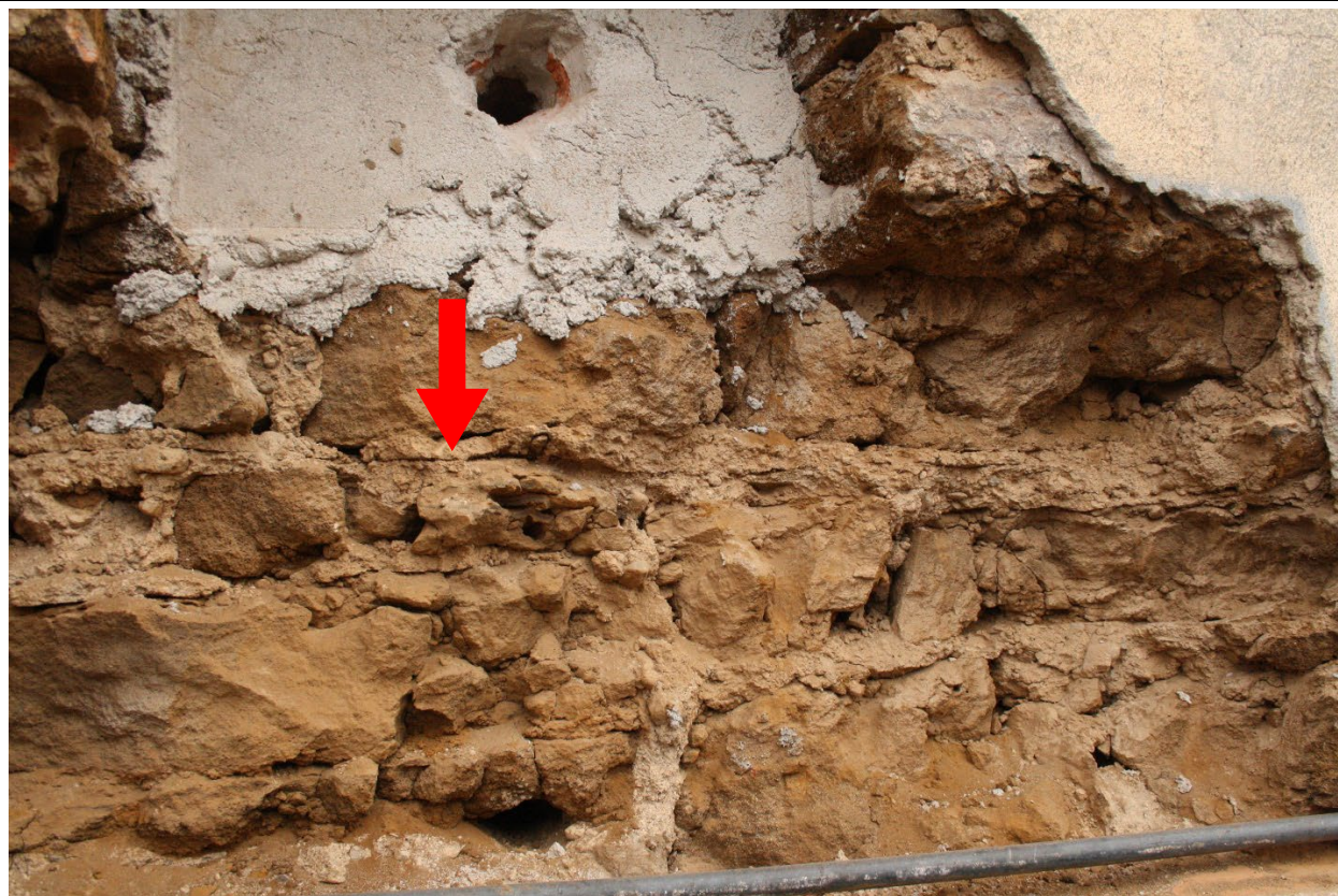
Detail zdiva na jihu presbytáře s vyznačeným rozhraním dvou vrstev utážených malt, dokládající zřejmě sezónní přerušování stavby. Foto: Jaroslav Skopec 2013.
